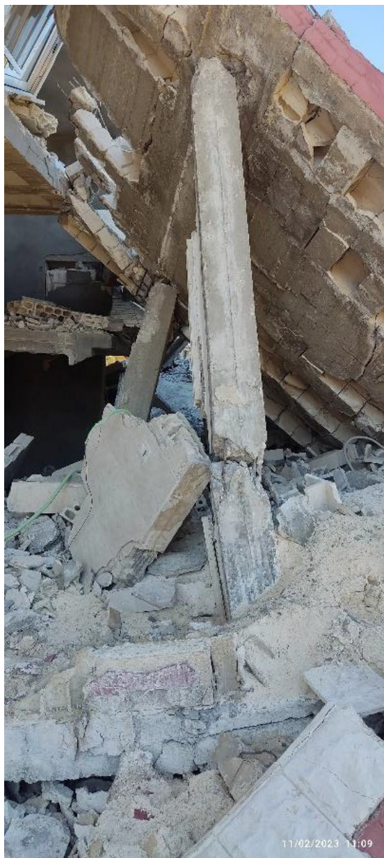
Figura N° 15. Falla por corte en columnas
