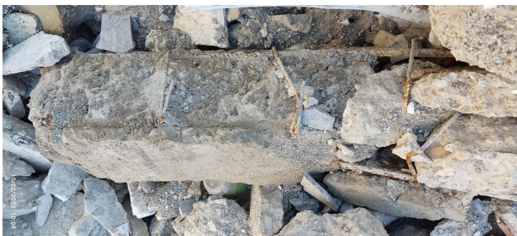
Figura N° 11. Acero con corrosión
