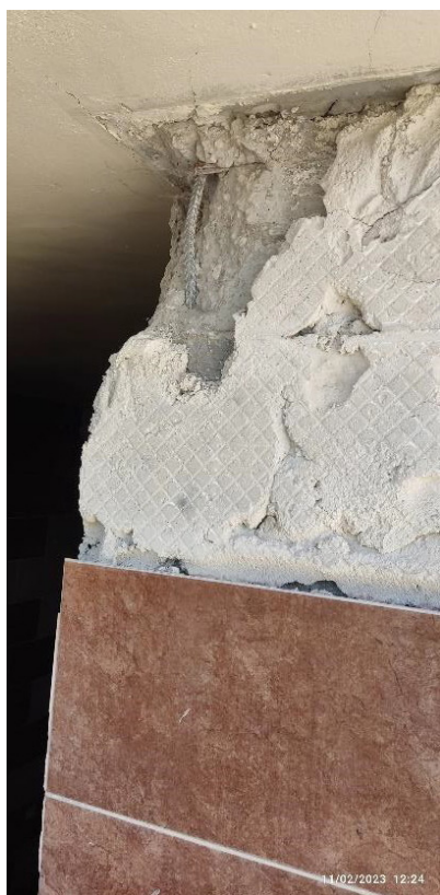
Figura N° 18. Pandeo de acero de refuerzo
