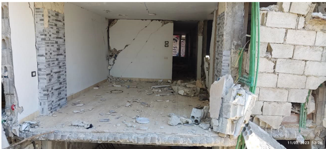
Figura N° 17. Daños en paredes internas
