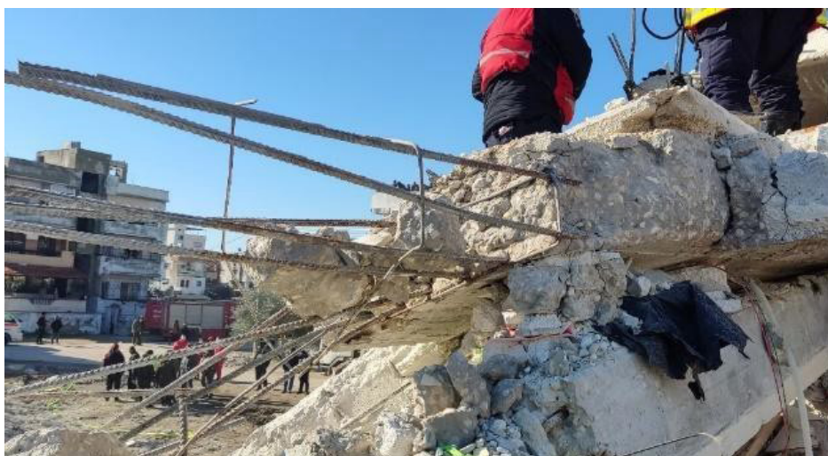
Figura N° 10. Acero incumpliendo con especificaciones
