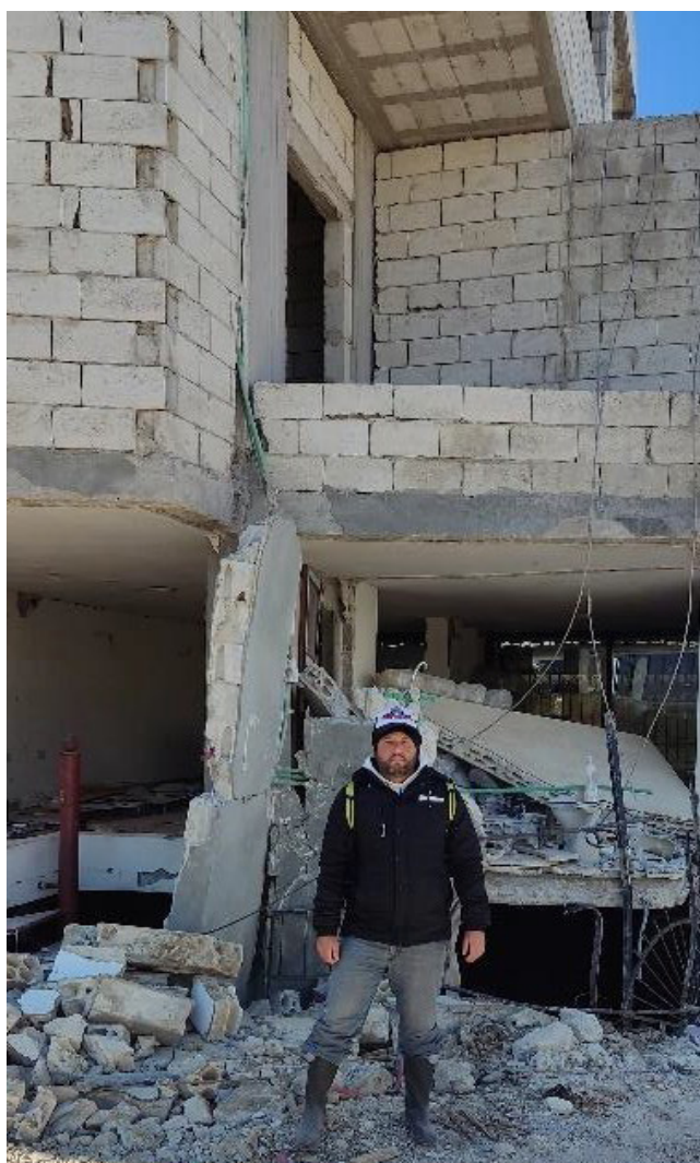
Figura N° 16. Daños en mampostería
