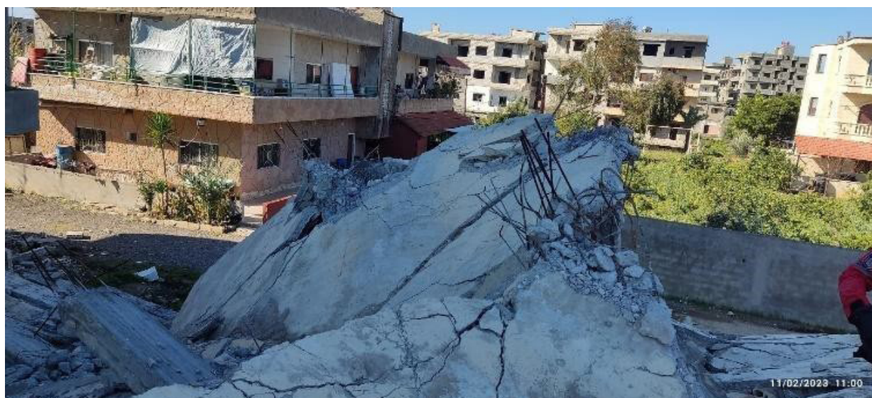
Figura N° 14. Vista de punzonamiento de losa
