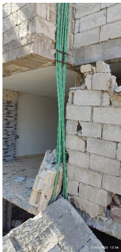
Figura N° 19. Tuberías interviniendo la losa
